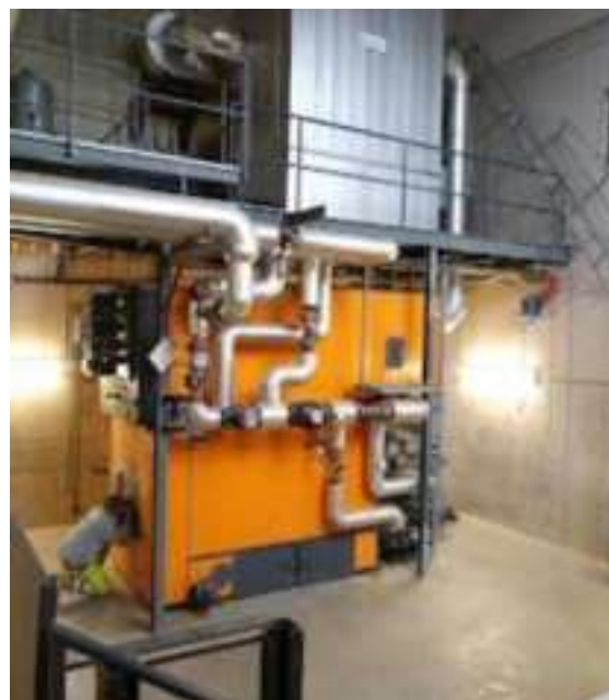
Blick in die Heizzentrale Marthalen Quelle: https://www.bagger-stutz.ch
